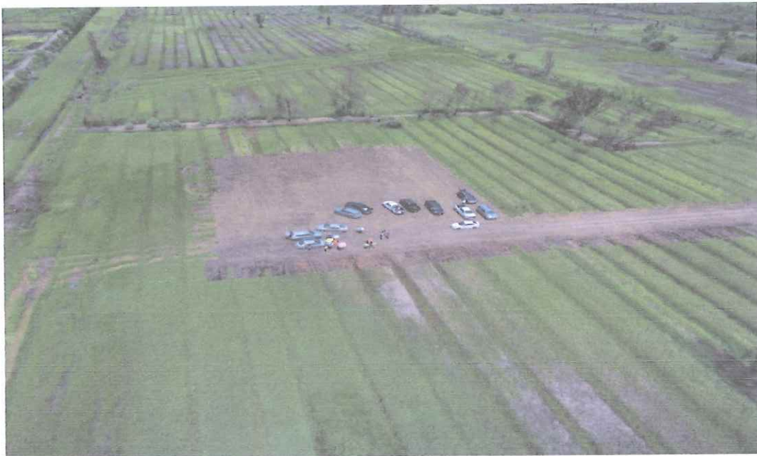
งานปรับพื้นที่บริเวณก่อสร้าง
